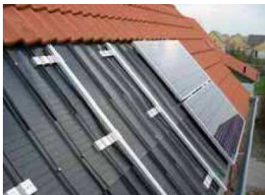
Impianto fotovoltaico "integrato"
