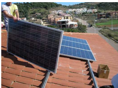
Impianto fotovoltaico "parzialmente integrato"
